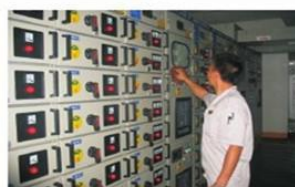
设施设备维修保养组领班姚立强对设备进行日常维护保养
