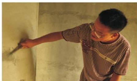
下午，土建工程师刘继本在二期30楼，逐个房间对每一面墙检查空鼓情况，检查到的空鼓——做好标记并整改，尽可能将空鼓可能性减小到零。
