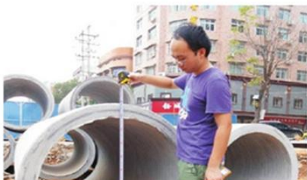
工程管理中心李蒙，远赴平江天岳大道现场检查混凝土管直径及厚度，严把质量关。
