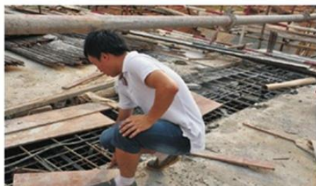
三期的工程师段雄伟顶着炎炎烈日，穿梭在41-43#楼、及46-48#楼各楼栋中，他从不抱怨，尽管大汗淋漓、身体疲乏，依旧坚守岗位，严把质量、安全关。
